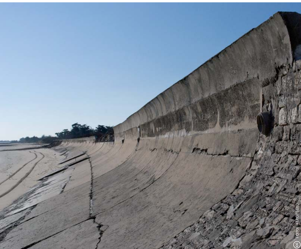
De dijk bij Le Martray, een landengte op het eiland Ile de Ré vlak voor de Franse kust ten zuiden van de Vendée, is door de storm zwaar beschadigd.
